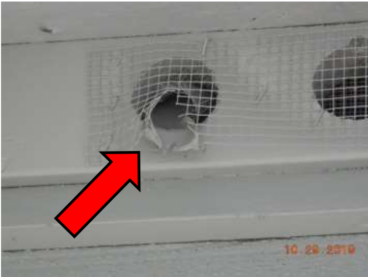
Torn eave vent
